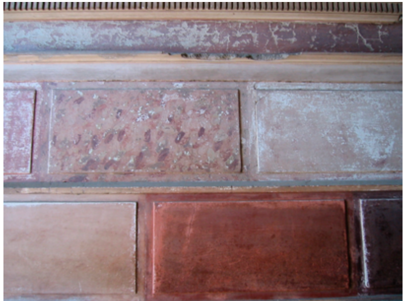
Figura 01 - Parede imitando o mármore.
