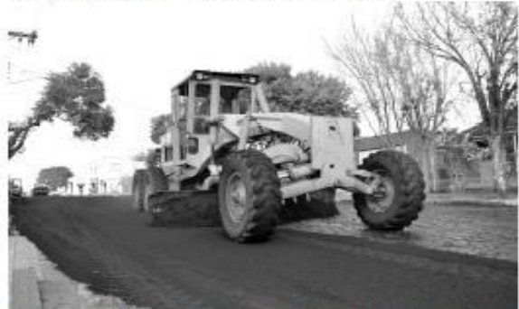
Assim administração já investiu aproximadamente R$ 8 milhões em mobilidade urbana na primeira etapa das obras.
