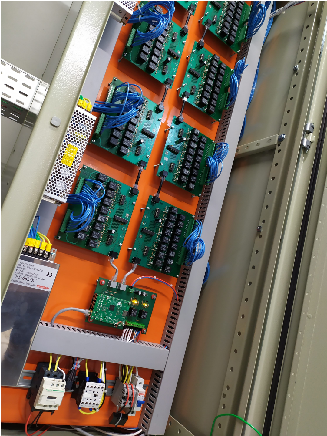
Figura 4.3 – Controlador com todos níveis acionados
