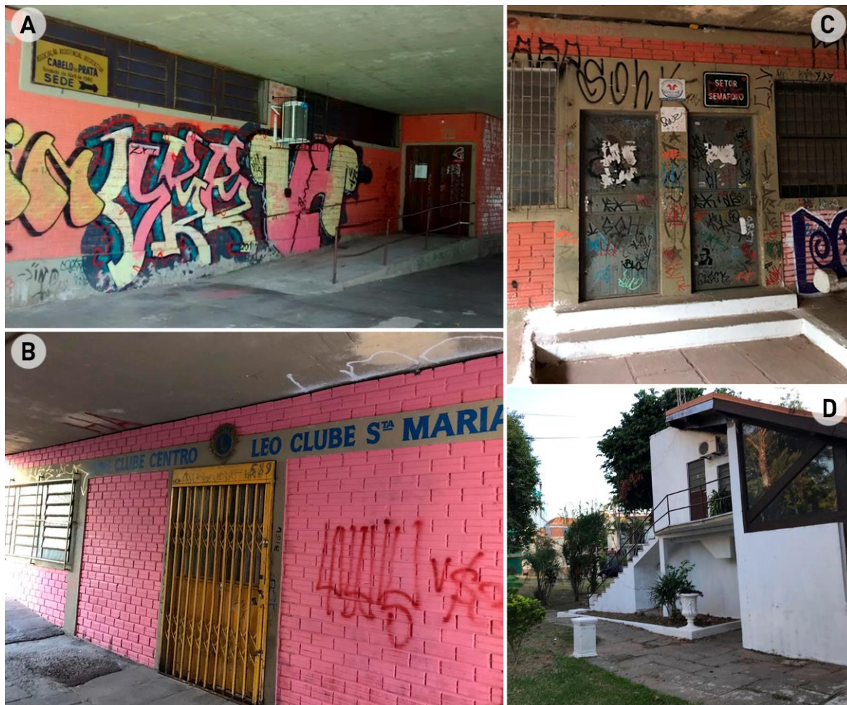
Figura 40 – Edificações ao longo do Parque Itaimbé: Associação A. R. Cabelos de Prata (A), Lions Clube (B), edificação sem uso (C) e edificação de apoio da GSM (D).
