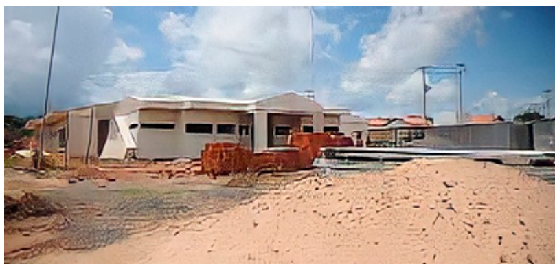
Figura 3 – Obra inacabada/paralisada de projeto padrão tipo B – MI – Proinfância
