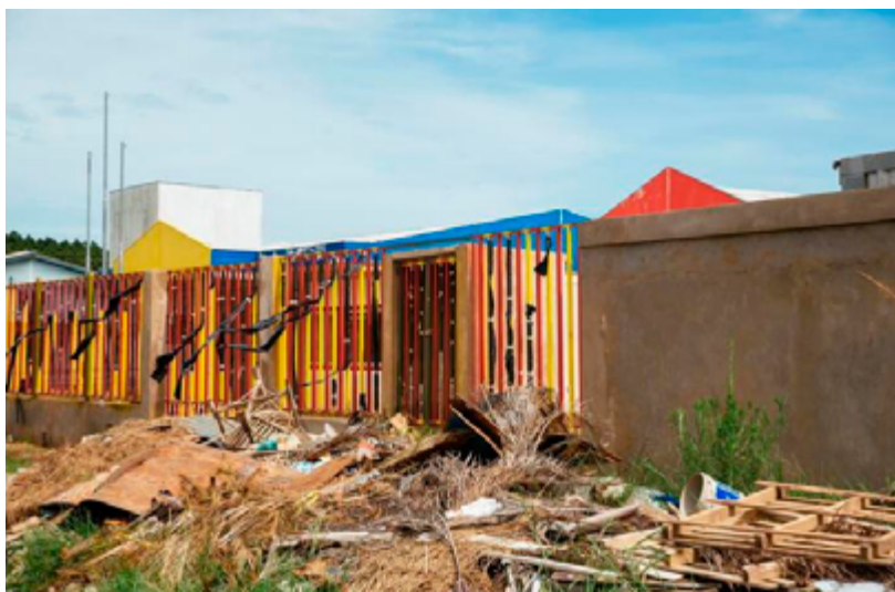
Figura 6 – Obra abandonada de creche – Proinfância
