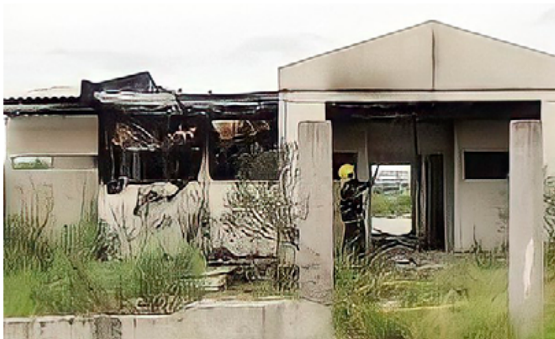
Figura 5 – Fachada de obra depredada de creche – Proinfância
