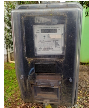
Figura 6: Caixa com medidor eletrônico em entrada de energia residencial.
