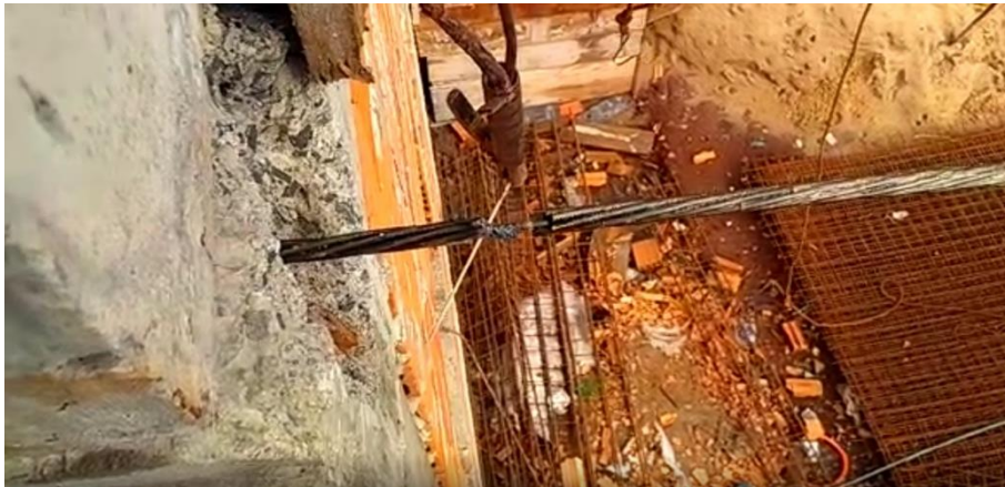
Figura 23 - Processo de troca de cordoalha após rompimento.
