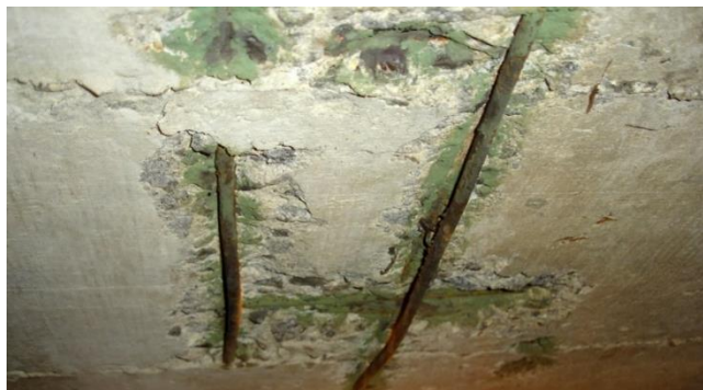
Figura 19 - Falha no posicionamento da face inferior das cordoalhas na laje.
