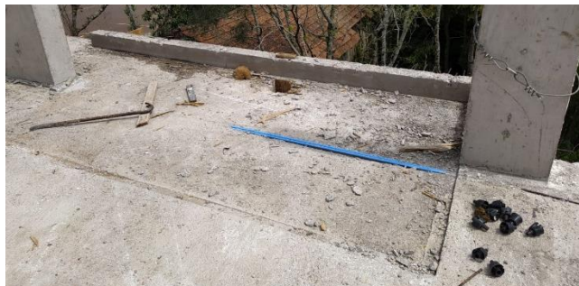
Figura 20 - Falha no posicionamento da face superior das cordoalhas na laje.
