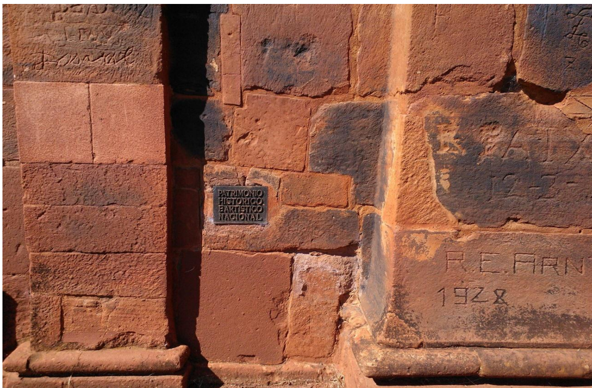
Figura 15 – Parte frontal da Igreja da ex-redução de São Miguel das Missões e a depredação ocasionada por atos de vandalismo
