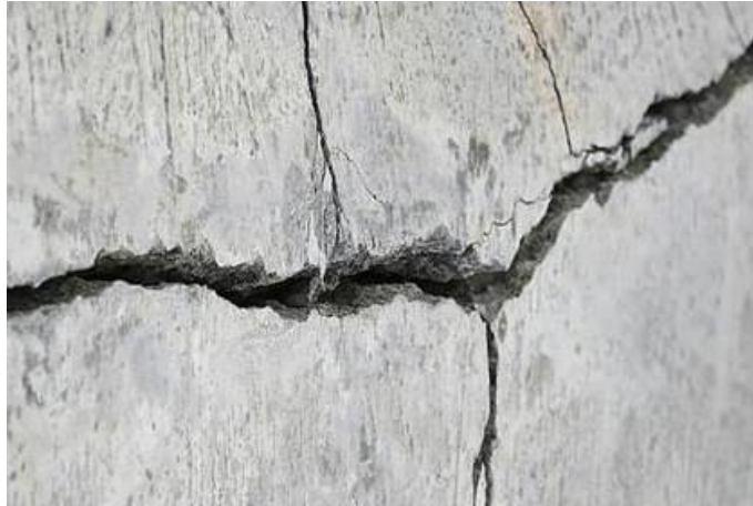
Figura 01: Exemplo de manifestação patológica – fissura.
