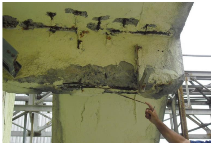
Figura 03: Estrutura danificada pela corrosão.
