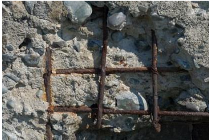
Figura 02: Demonstração da corrosão do aço na estrutura (patologia).
