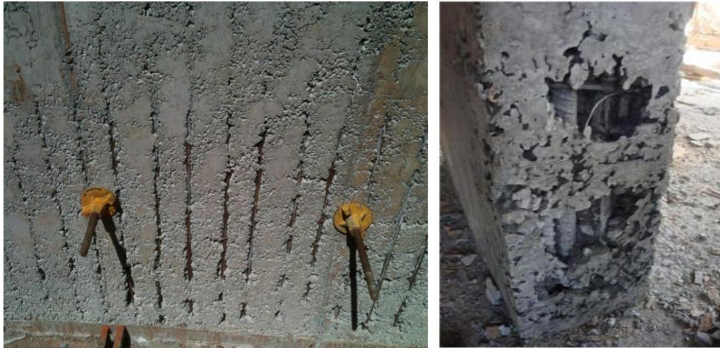
Figura 27: Mal adensamento do concreto resultando em armadura exposta.
