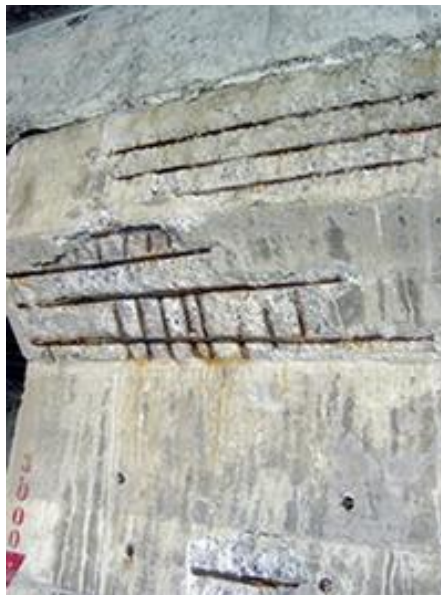
Figura 09- Exemplo de estrutura onde ocorreu o destacamento do concreto de cobertura.
