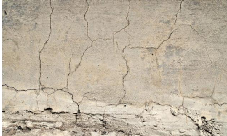
Figura 15: Fissuras provenientes da cura indevida ao concreto.
