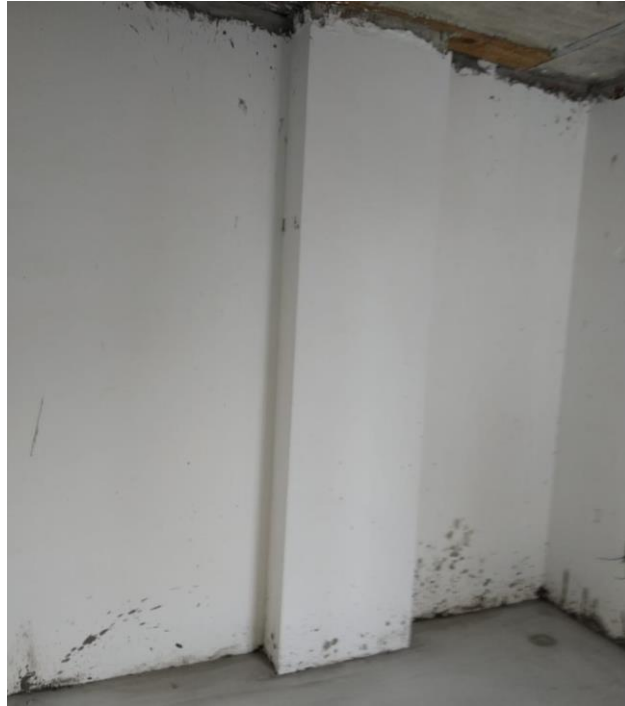
Figura 27: Dormitório com pilar excedendo as dimensões das paredes.
