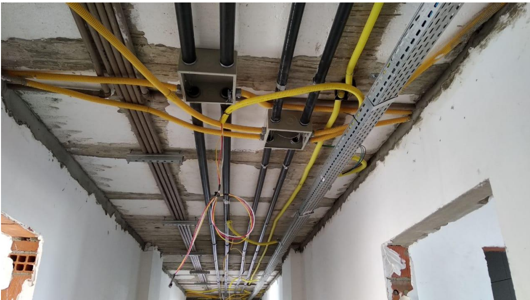
Figura 35: Interferências geométricas: elementos hidráulicos e elétricos.
