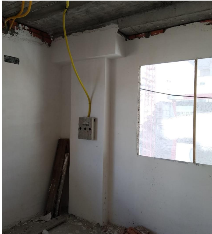
Figura 25: Pilar e viga em desconformidade em relação à alvenaria.
