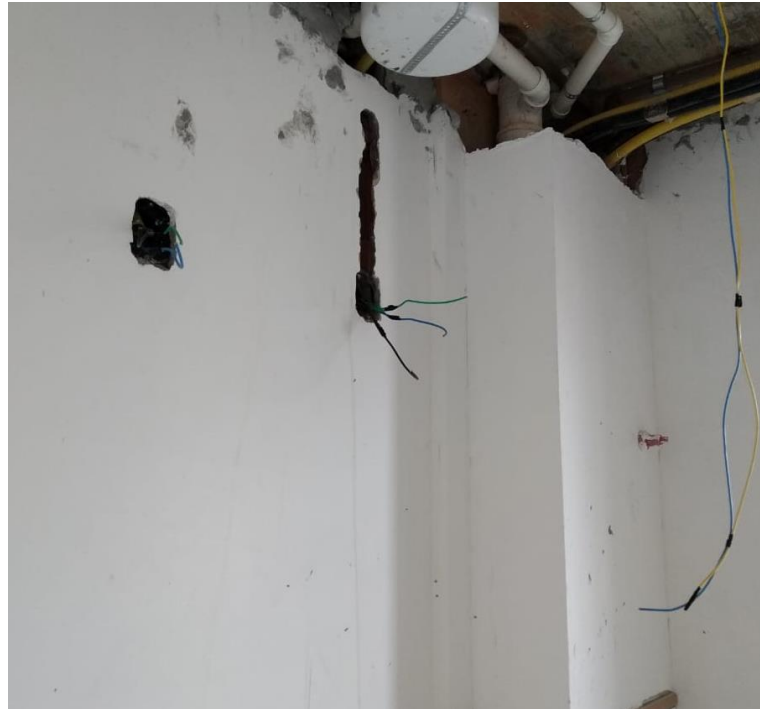
Figura 32: Retrabalhos em pontos elétricos.
