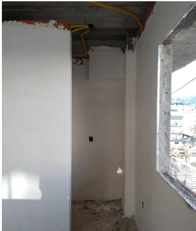
Figura 26: Pilar e viga em desconformidade em relação à alvenaria.
