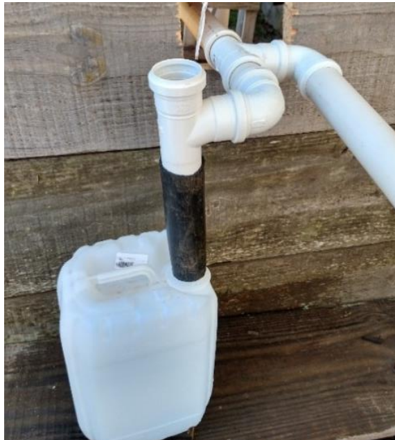
Figura x – Tubulação e Conexão “T” conectada ao dispositivo de descarte inicial
