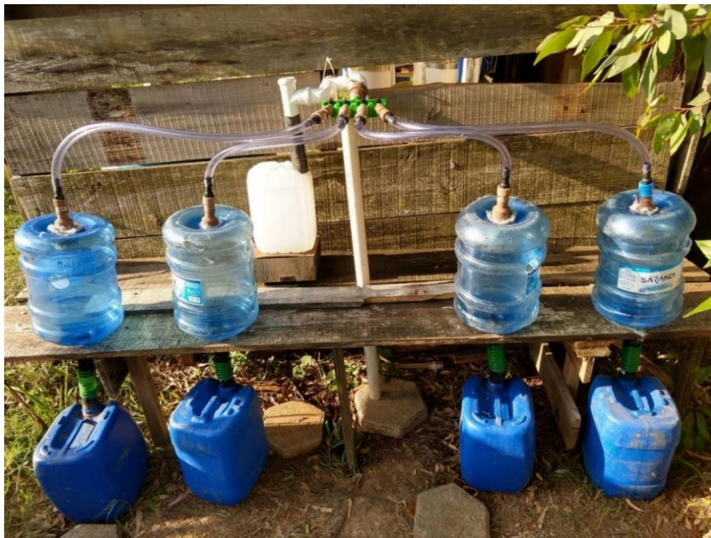
Figura 5– Sistema de filtração acoplado ao telhado verde
