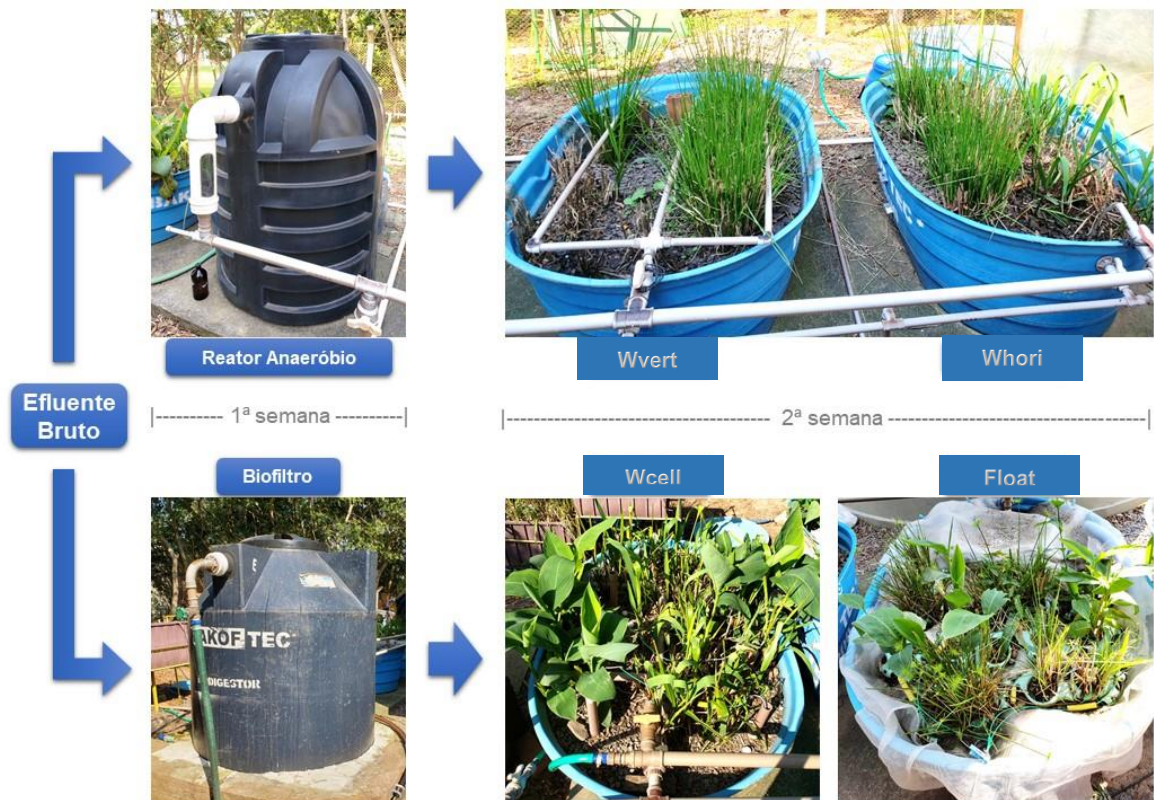
Figura 6 - Sistema Wetlands construídos avaliados.
