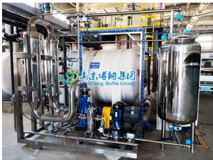
Figura 46 - Estação de diafiltração.
