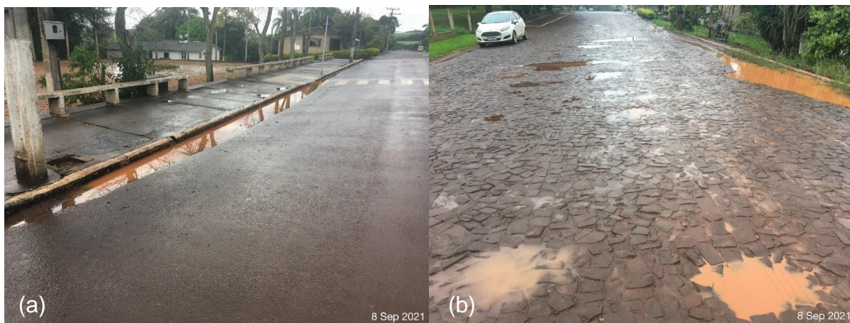
Figura 21 - Defeitos no pavimento constatados em observação a campo: drenagem lateral inadequada (a) e corrugação (b).
