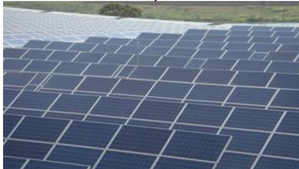
Figura 2.4 - Usina solar fotovoltaica de Tanquinho
