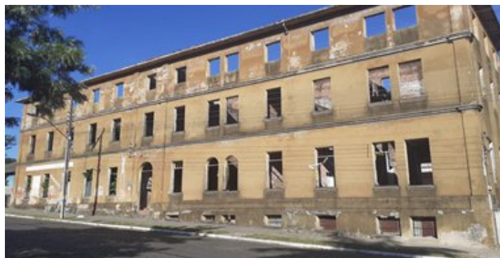
Figuras 17 e 18 – Ruínas da Escola São Carlos
