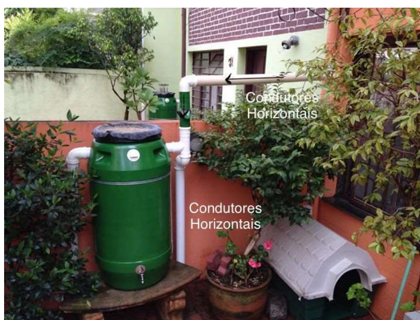
Figura 4 - Exemplo de Condutores instalados juntamente com o Sistema de Captação da água da chuva
