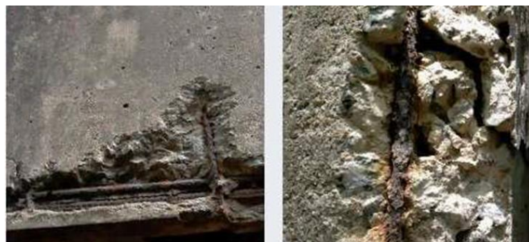
Figura 2 – Deslocamento do concreto e corrosão da armadura
