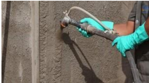
Figura 16 – Recomposição superficial do concreto
