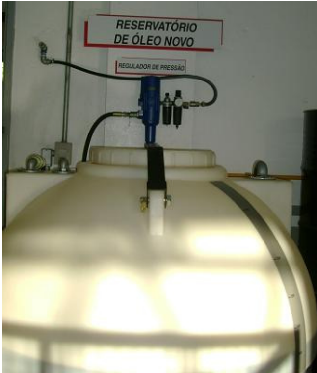
Figura 30 – Reservatório de óleo novo Fonte: Concessionária CarHouse , Santa Maria (2010).
