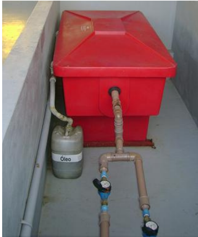
Figura 27 – Caixa separadora de água e óleo Fonte: Concessionária CarHouse , Santa Maria – RS (2010).
