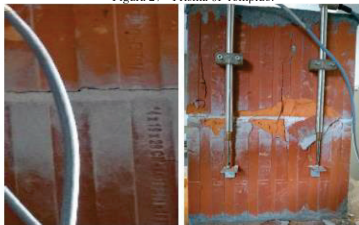
Figura 27 - Prisma 6F rompido.
