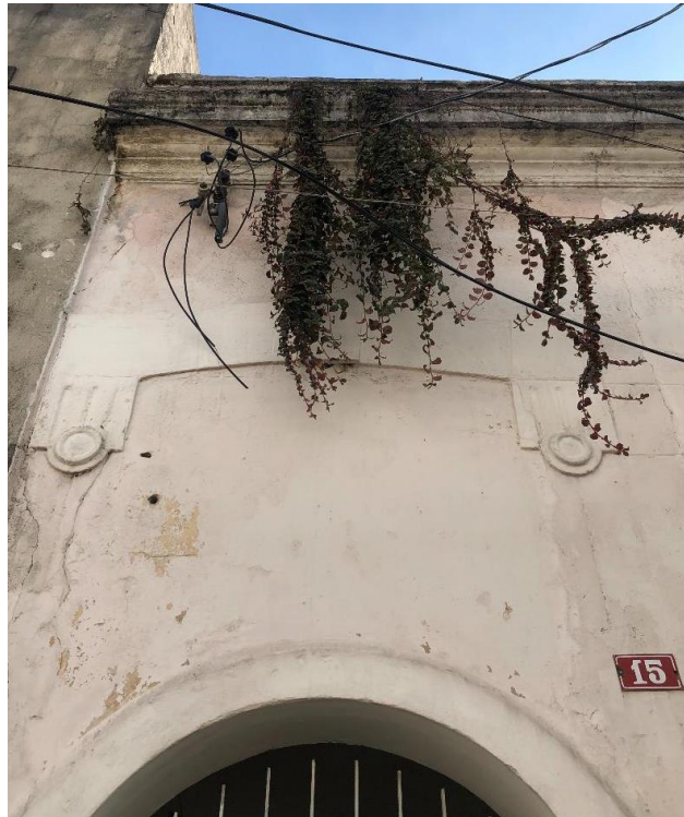
Figura 1 - Patologia (vegetação) identificada na casa n.15, Vila Economizadora – São Paulo-SP. Fonte: Autores, março de 2019.
