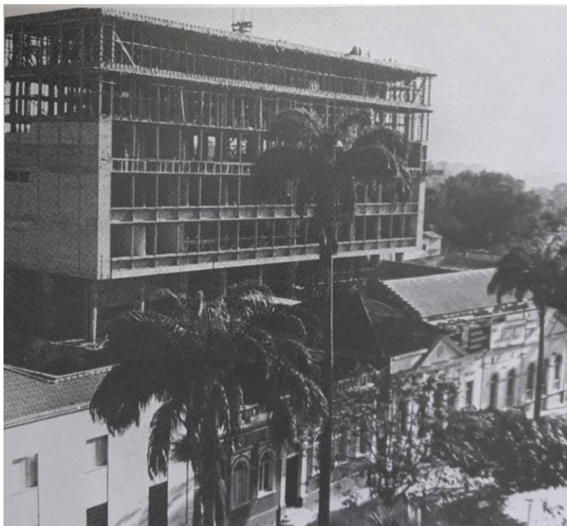
Figura 3 - Construção do novo Palácio do Governo, nos fundos da Delegacia Fiscal, Palácio Alencastro e da independência Municipal. Década de 1960. Fonte: SIQUEIRA et al. (2006)
