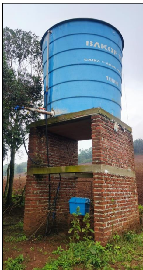
Figura 22 – Foto do reservatório elevado de água tratada e reservatório de cloro integrantes do SAA do Lajeado Fortuna, 2023
