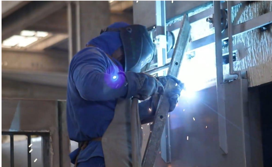
Figura 46 – Solda das portas de correr em metal, junto ao módulo de concreto
