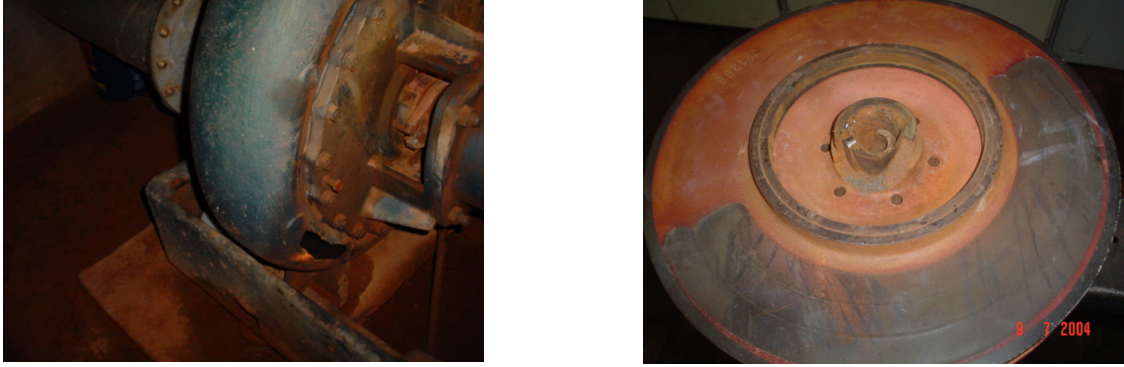
Figura 3.3 - Carcaça e rotor de bomba que apresentaram problemas.
