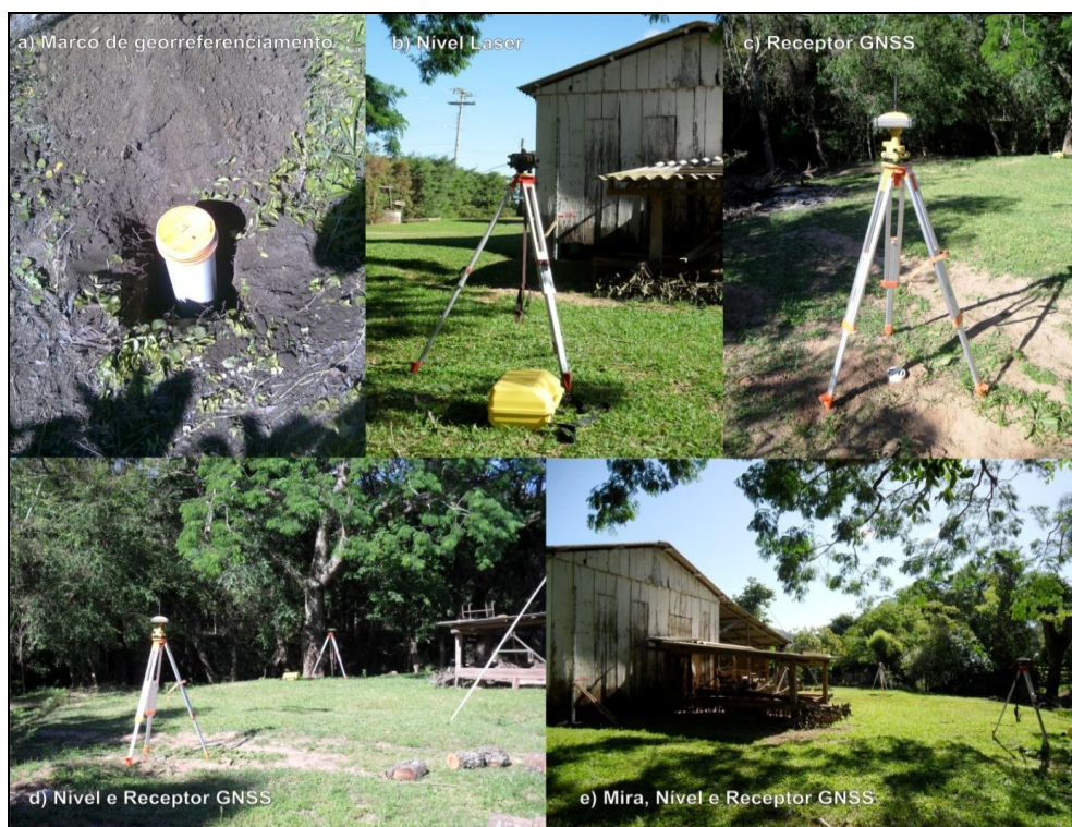
Figura 37 – Procedimento de nivelamento georreferenciado: a) marco de georreferenciamento; b) Nível laser; c) Receptor GNSS sobre o marco; d) Receptor GNSS e Nível; e) Mira, Nível e ao fundo o receptor GNSS.
