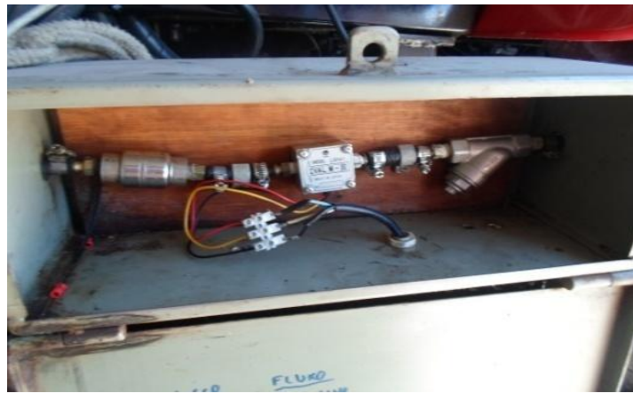
Figura 14 - Caixa de proteção e ligações do fluxômetro. Santa Maria/RS. (RUSSINI, 2009).
