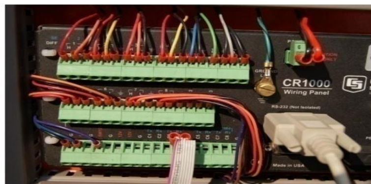
Figura 10 - Datalogger para armazenamento dos dados adquiridos pelos sensores. Santa Maria/RS. 2013.
