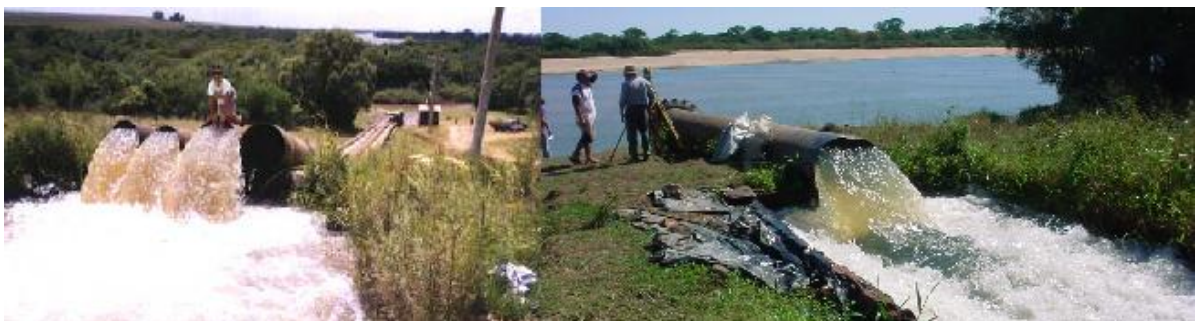
Figura 14. Tubulação com elevada turbulência na saída.
