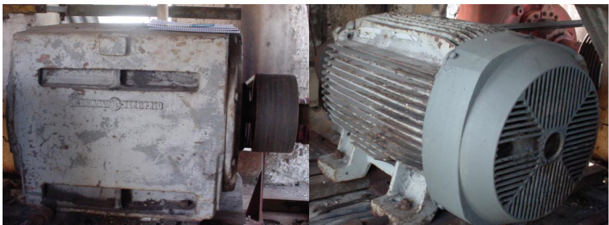
Figura 19. Motores elétricos encontrados em campo.
