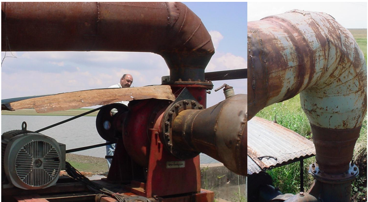
Figura 11. Aspecto das curvas utilizadas na saída das bombas instaladas em posição com eixo horizontal.
