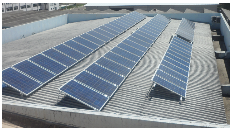
Figura 49 – Painéis utilizados no ensaio experimental da arquitetura híbrida
