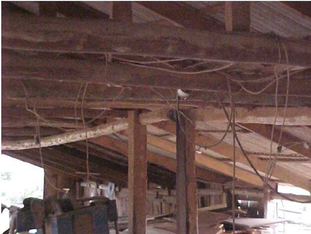
Figura 15 – Instalações elétricas expostas
