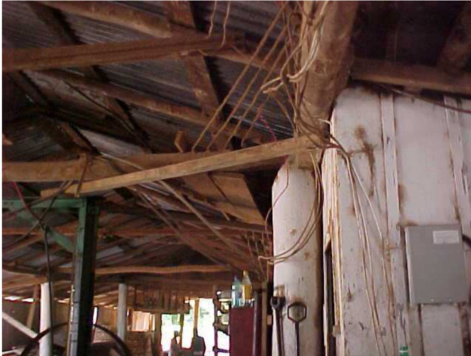
Figura 16 – Instalação elétrica exposta de maneira inadequada
