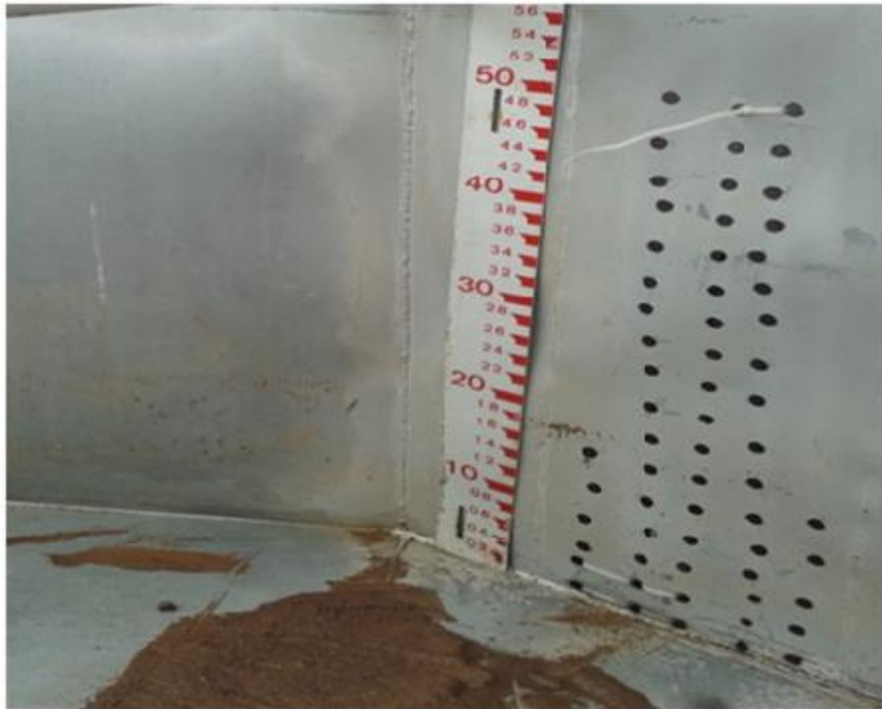
Figura 26 - Monitoramento da descarga líquida. Régua linimétrica.
