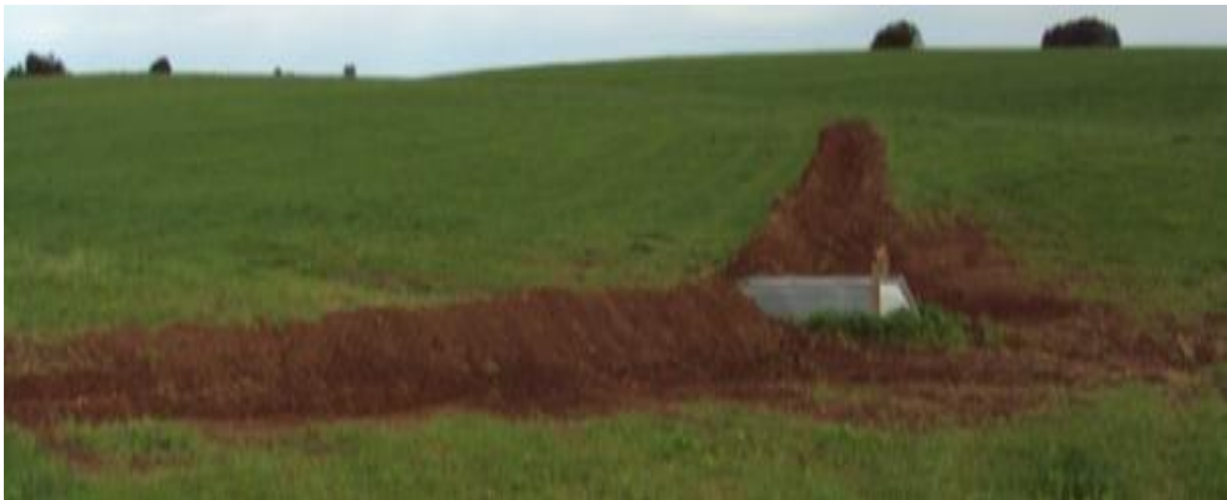
Figura 17 - Faixas de contenção construídas para evitar a saída e entrada de água nas bacias pareadas.
