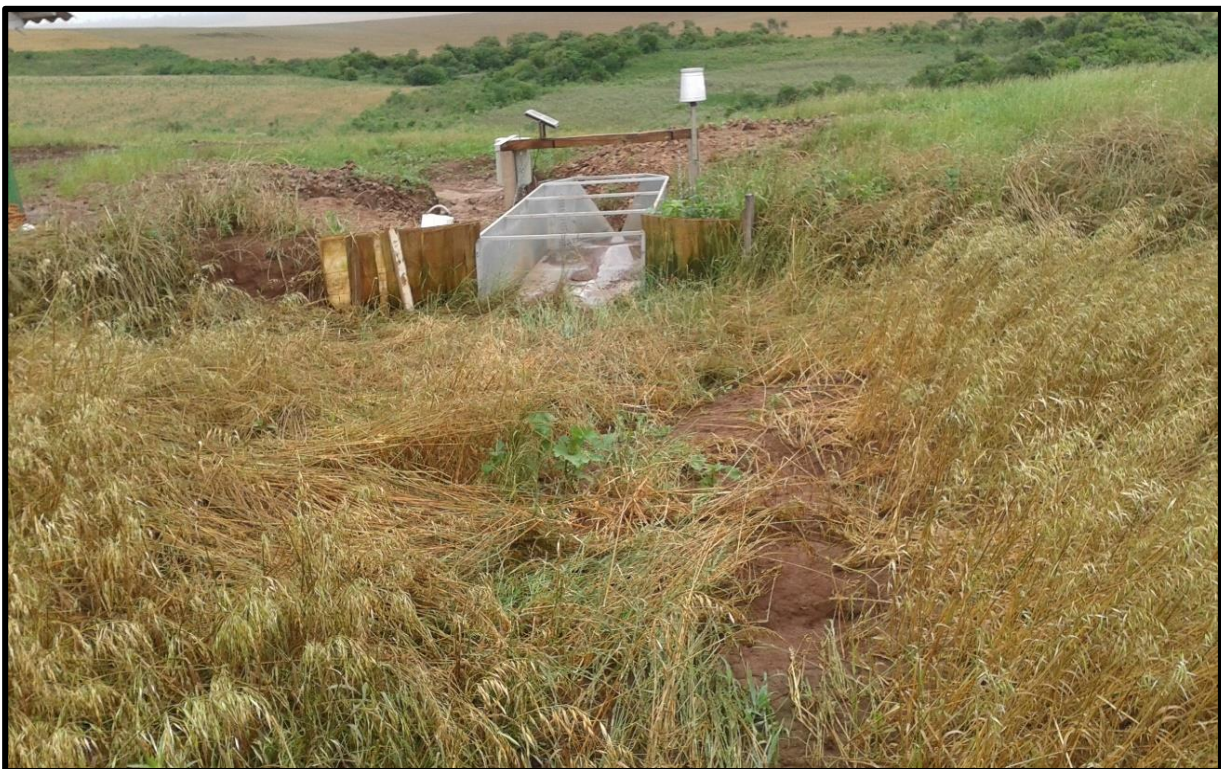
Vertedouro ST após evento 03/11/2014.
