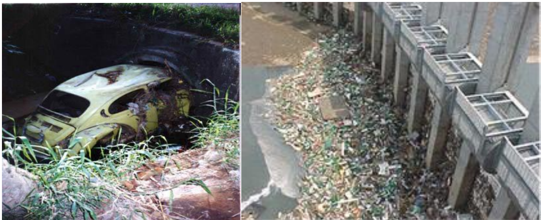
Figura 3- Obstrução e lixo retido na drenagem. Fonte: Tucci, 2005, p. 97.
