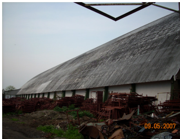
Figura 4.17 – Entulhos, favorecem a presença de roedores.
