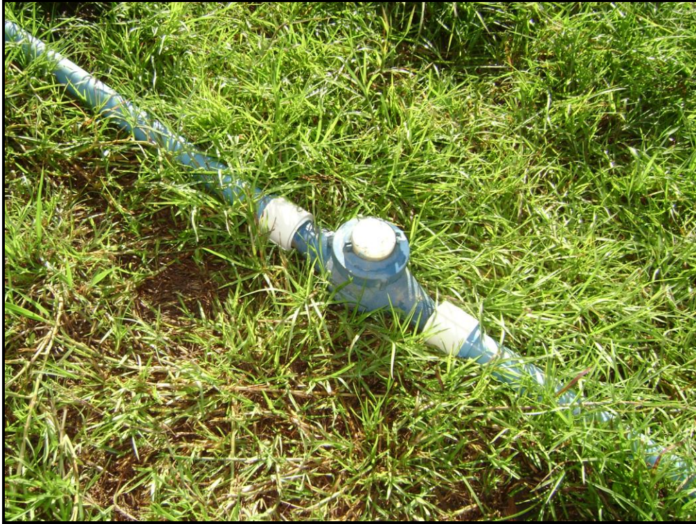
Figura 08 – Hidrômetro instalado no início da linha principal. Santiago, RS. 2007
