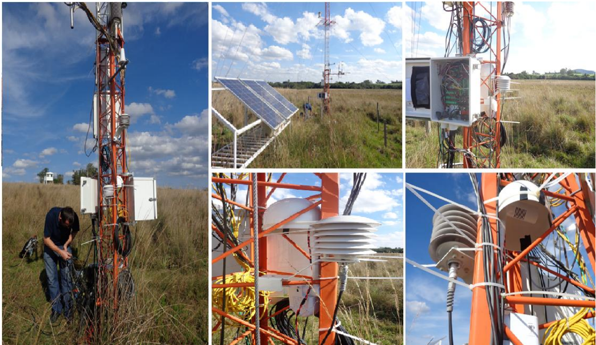
Figura 31 - Teste 3 – Pampa (Torre de micro-SULFUX).
