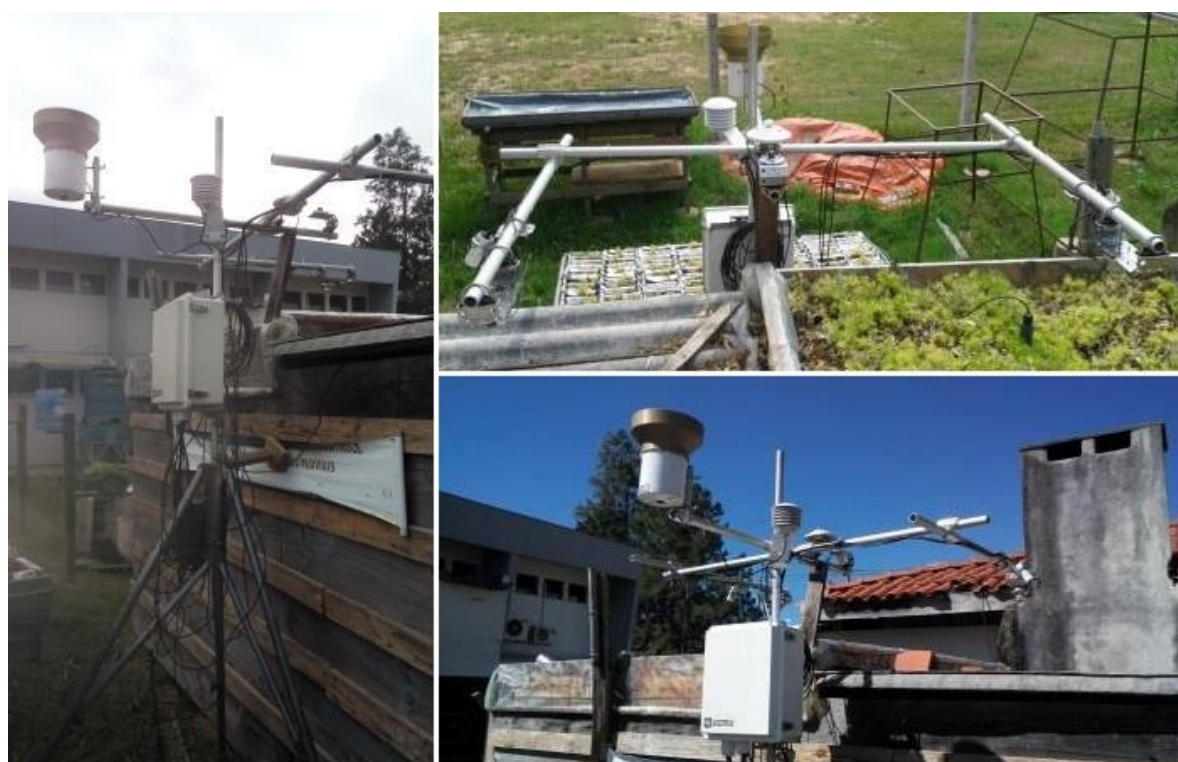
Figura 17- Estação meteorológica instalada no telhado verde experimental.
