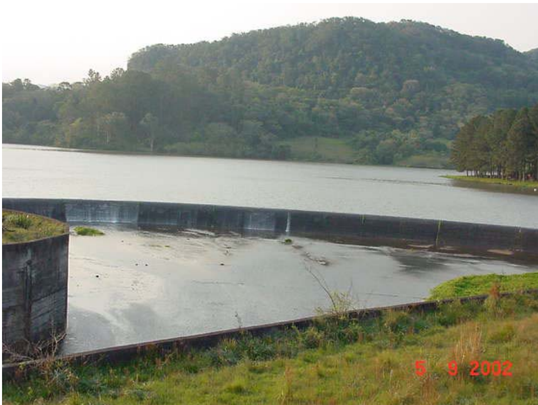
Figura 18 – Vertimento parcial observado na crista do vertedor
