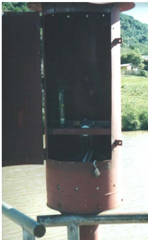
Figura 17 – Estação fluviométrica Barragem
