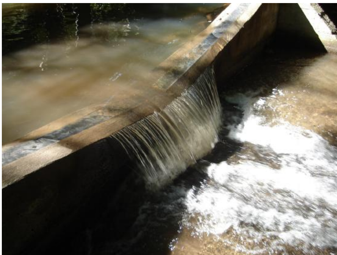
Figura 4.19 – Vertedor em V instalado no ponto de Jusante
