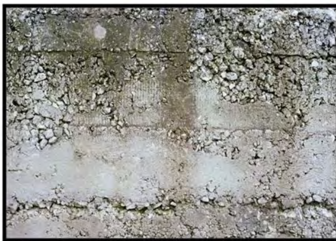
Figura 3.1 – Aparência do concreto após a desforma, imagem sem ampliação.
