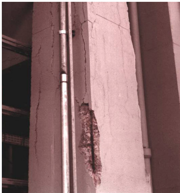
Figura 1.5 – Corrosão em estruturas executadas com aditivo com cloretos (Vagheti et al., 2002)
