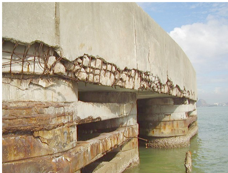
Figura 1.6 Estrutura localizada na linha da maré severamente deteriorada. Fonte: Aguiar (2006).
