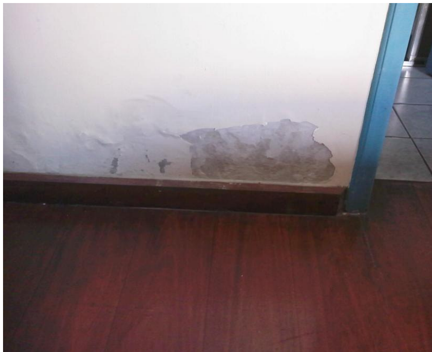
Figura 41 – Patologia em revestimento devido à umidade ascendente (ACERVO DO AUTOR, 2009).
