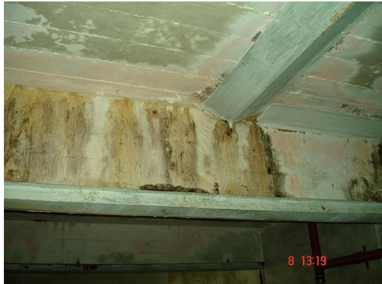
Figura 53 – Infiltração em viga situada abaixo da junta de dilatação. (ACERVO DO AUTOR, 2007).
