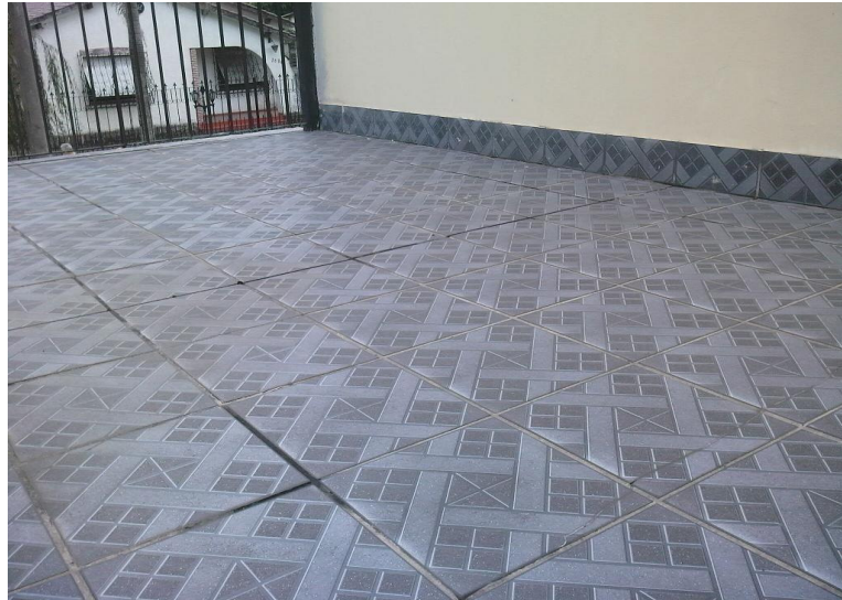
Figura 51 – Face superior da mesma laje, apresentando fissuras. (ACERVO DO AUTOR, 2009).
