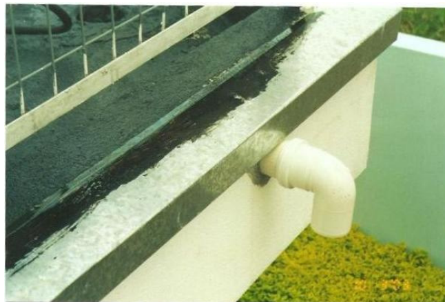
Figura 27 – Pingadeira metálica. (ACERVO DO AUTOR, 2008).
