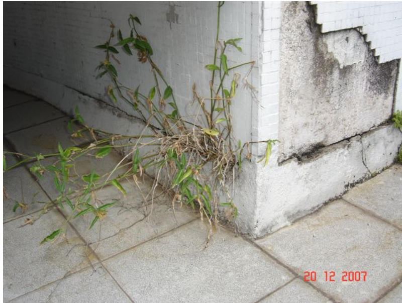
Figura 54 – Patologia em rodapé. (ACERVO DO AUTOR, 2007).
