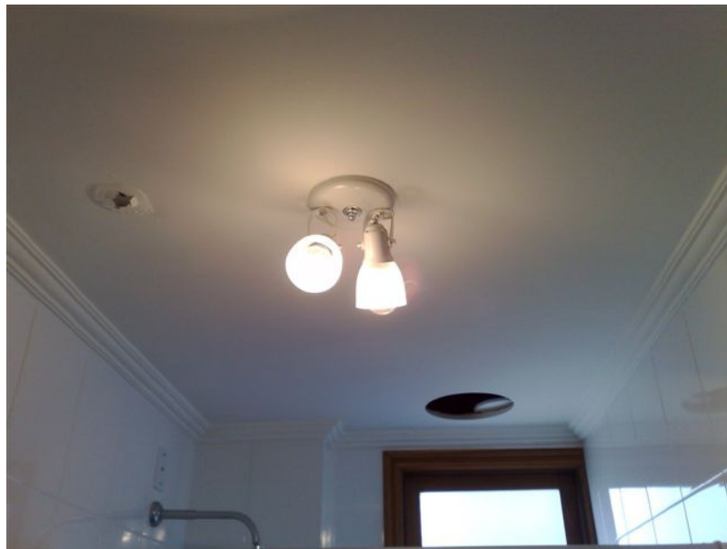
Figura 44 – Patologia em forro de banheiro. (ACERVO DO AUTOR, 2008).
