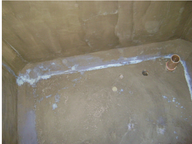
Figura 20 – Cantos chanfrados em reservatório. (ACERVO DO AUTOR, 2007).
