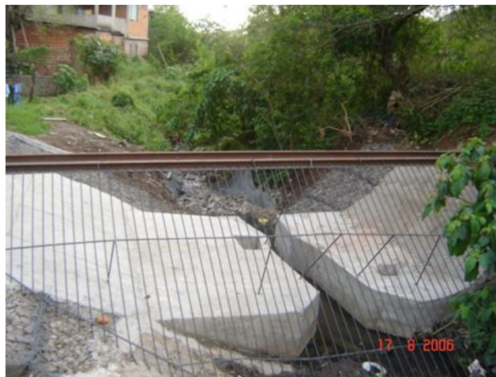
Figura 6 - Grade “Harpa”, a montante da calha Parshall.
