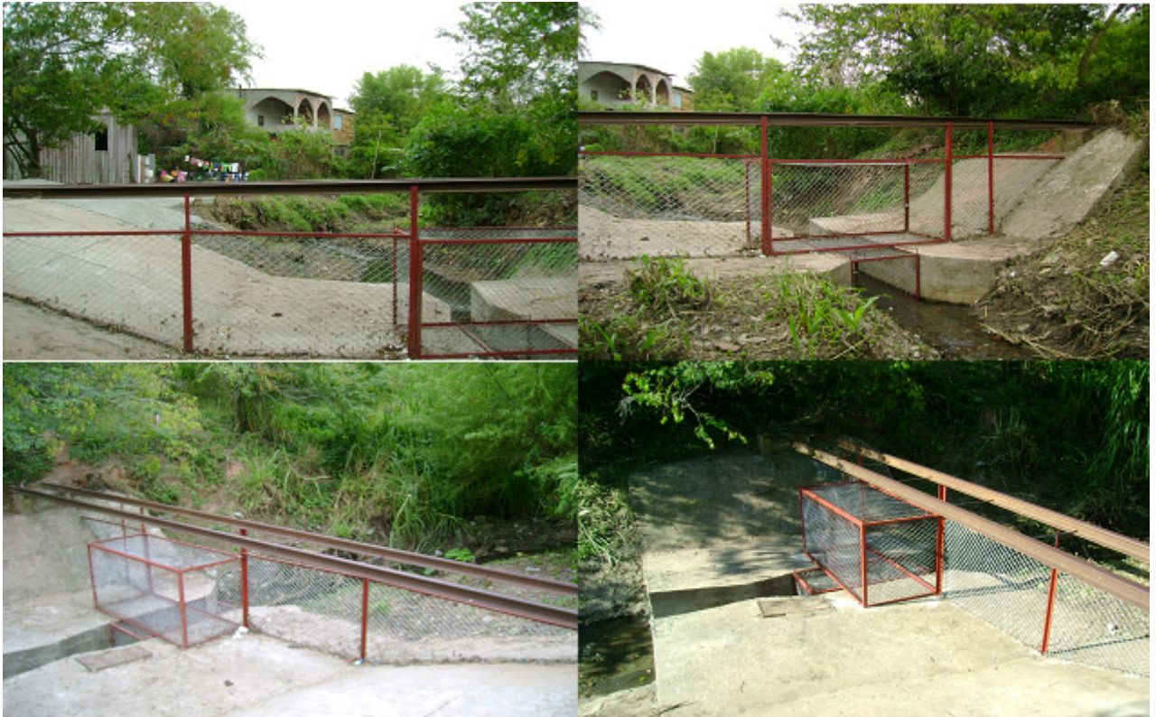
Figura 20 - Estrutura de contenção dos resíduos sólidos veiculados no arroio esperança em diferentes ângulos.
