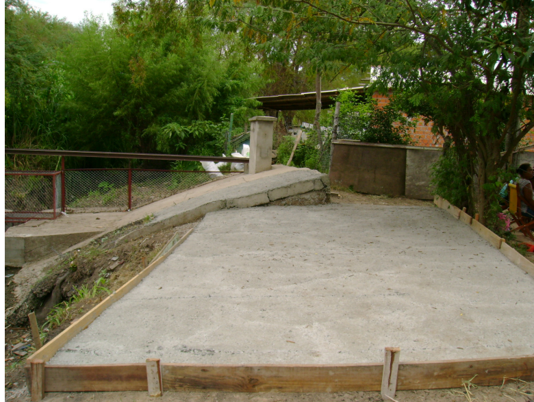
Figura 21 - Piso para disposição e escoamento do excesso de umidade dos RSD.
