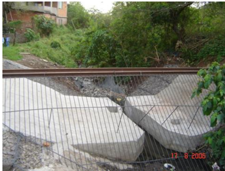
Figura 24 - Grade “harpa”, a montante da calha Parshall.
