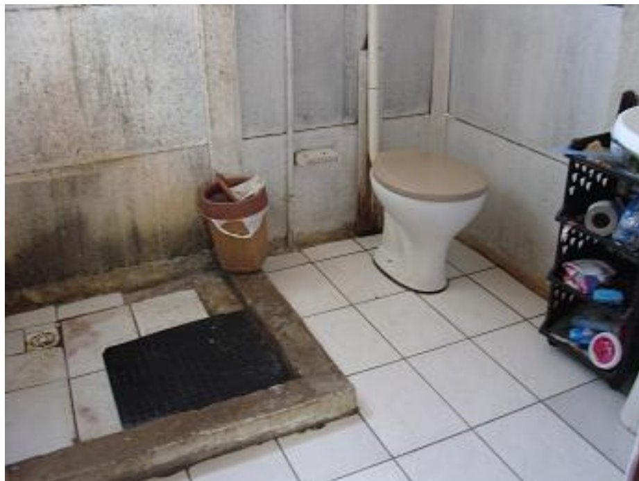
Figura 23 – Umidade ao redor de todo o piso do banheiro.
