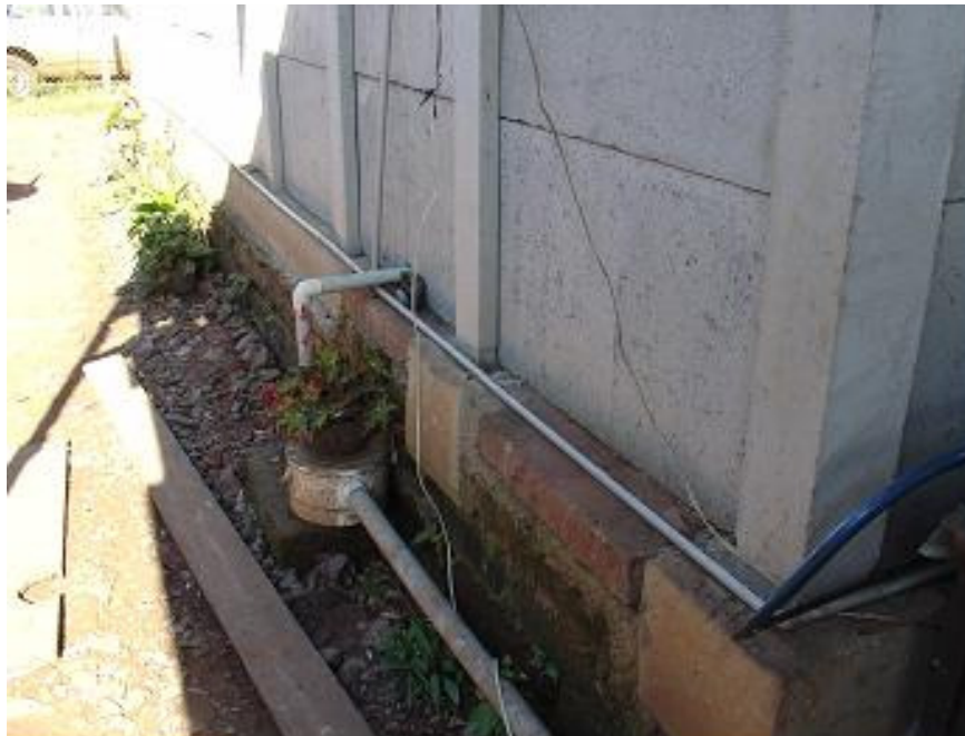
Figura 26 – Instalação hidrossanitária aparente.
