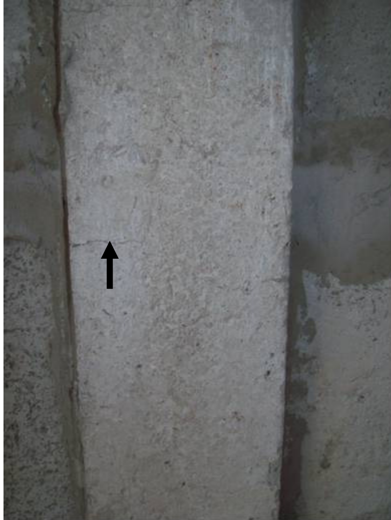
Figura 39 – Pilar entre as placas de 5 cm, visível microfissuras horizontais causadas pelo ajuste do aparelho.
