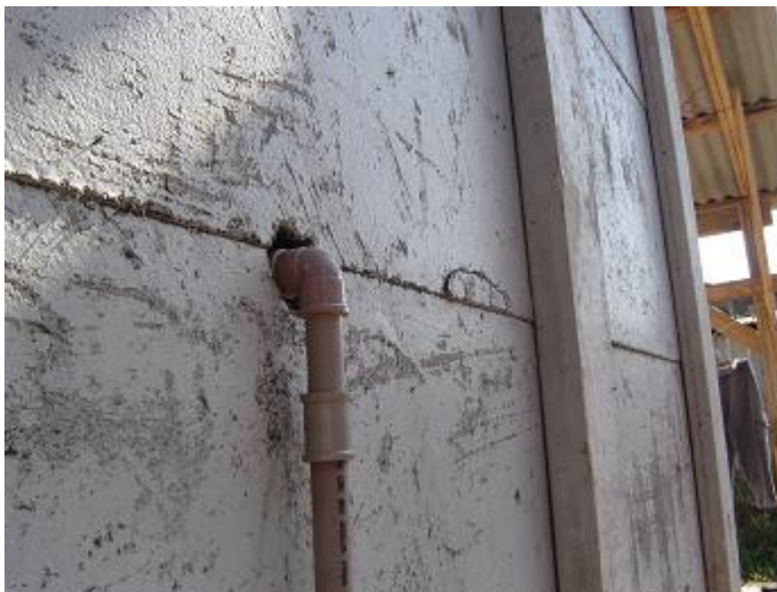
Figura 27 – Instalação hidráulica aparente.
