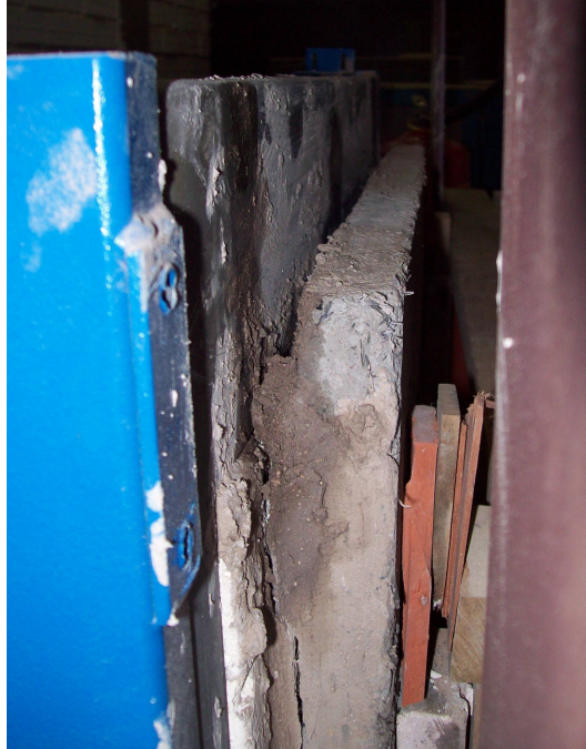
Figura 47 – Vista superior mostrando a formação de fissuras na terra refratária entre a placa e o forno; forno (azul, a esquerda), pórtico (marrom, a direita) e a placa de 3 cm no meio.
