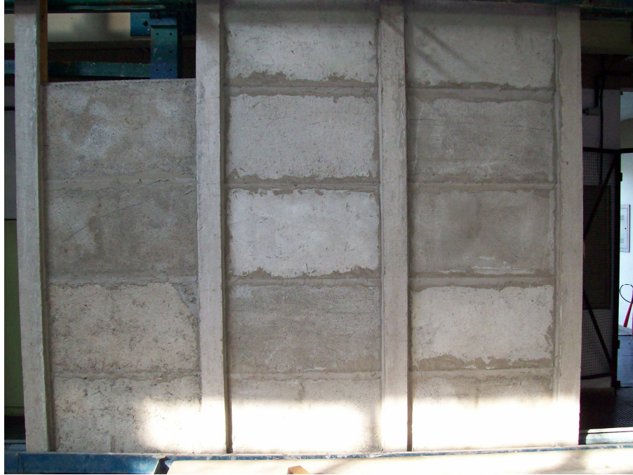
Figura 37 – Placas montadas para o teste, visível as juntas horizontais entre os painéis de 5 cm, com vedação de argamassa colante (AC2).
