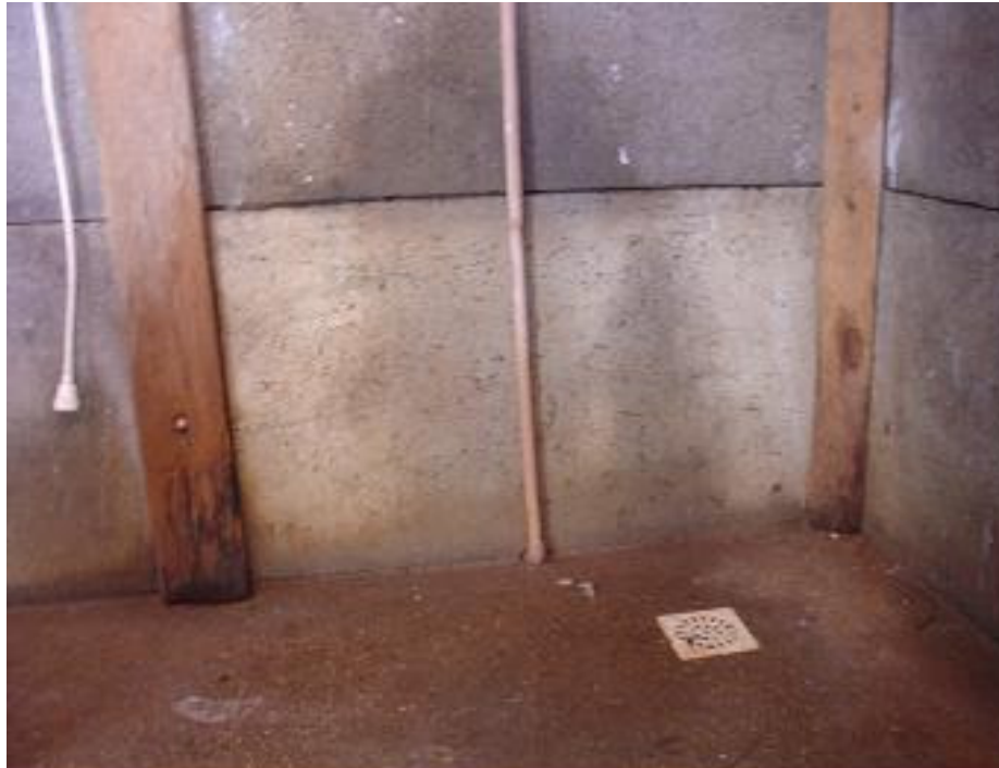
Figura 22 – Umidade nas placas do banheiro.
