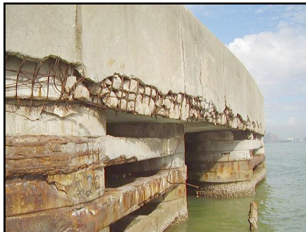
Figura 13 - Estrutura localizada na linha da maré severamente deteriorada. Fonte: Aguiar (2006).
