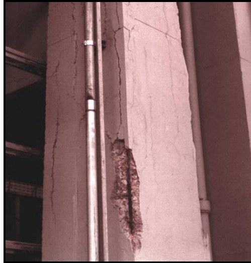
Figura 12 - Corrosão em estruturas executadas com aditivo com cloretos. Fonte: Vaghetti et al. (2002).
