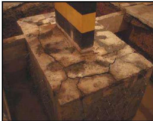
Figura 5 - Estrutura degradada pela RAA possível RAS em Recife, Brasil. Fonte: Andrade (2006).
