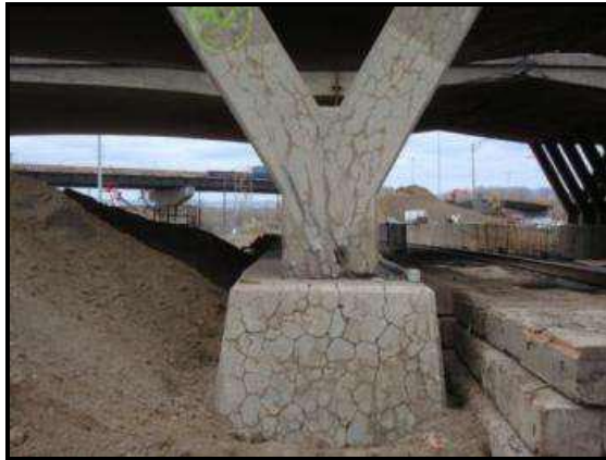
Figura 6 - Estrutura degradada pela RAA possível RAS no Viaduto Robert-Bourassa - Charest, Québec, Canadá. Fonte: Sanches (2010).
