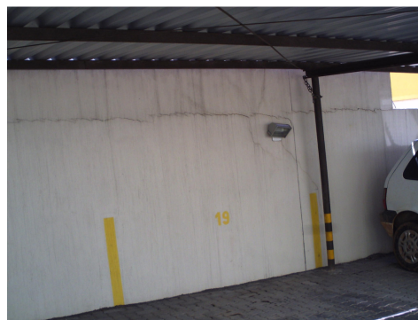
Figura 50 – Posição da fissura ao longo da parede do Edifício1.
