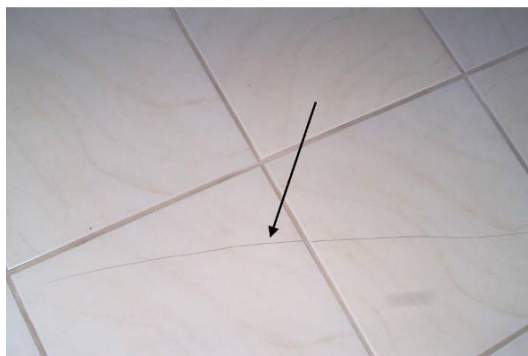
Figura 19 – Ocorrência de trincas nos pisos do Edifício 1.
