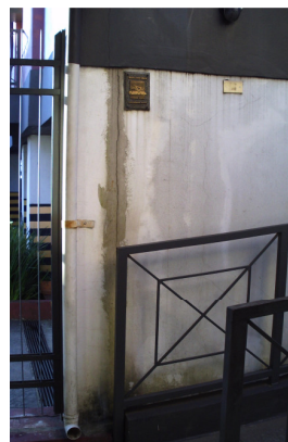
Figura 131 – Fissura vertical e umidade na parede.
