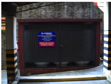
Figura 123 – Abrigo de gás adequado, fora do corpo do prédio.
