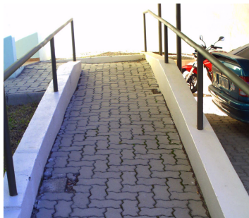
Figura 38 – Calçada com revestimento solto.
