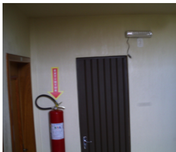
Figura 44 – Utilização inadequada da iluminação de emergência do Edifício 1.
