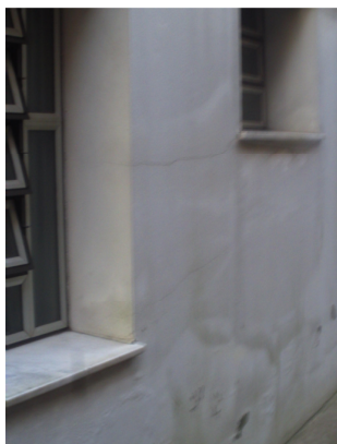
Figura 130 – Fissuras e manchas de umidade.
