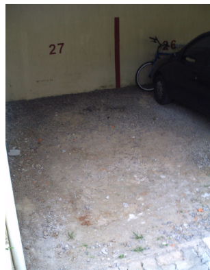
Figura 88 – Ausência de pavimentação no Box de estacionamento.
