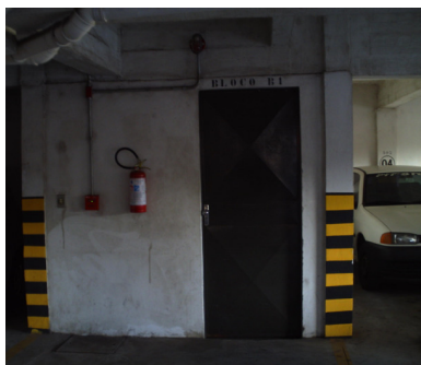
Figura 124 – Sinalização de incêndio.
