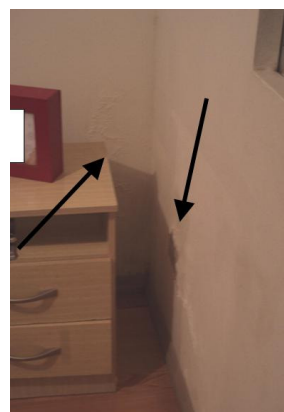
Figura 99 – Infiltração na parede.
