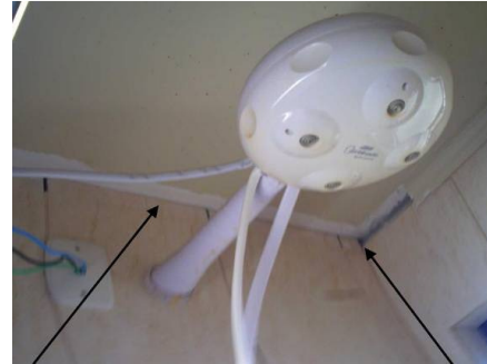
Figura 28 – Descolamento do roda-forro .
