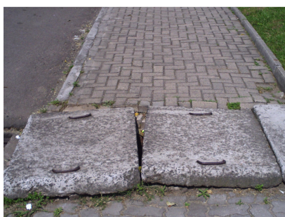
Figura 79 – Passeio público com obstáculos dificultando a passagem de pedestres.
