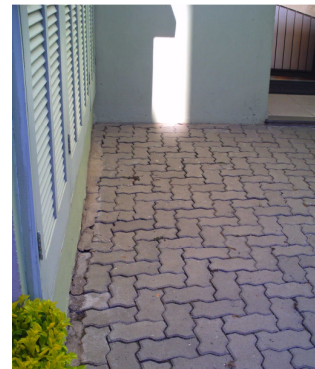
Figura 39 – Mau acabamento do piso.
