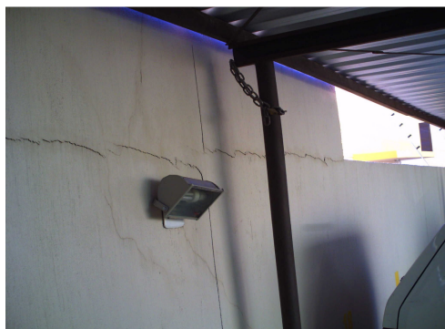
Figura 49 – Fissura horizontal na parede do estacionamento do Edifício1.
