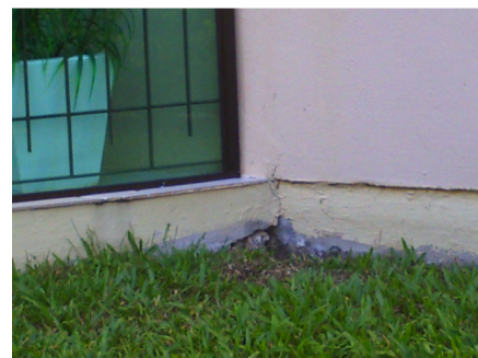
Figura 48 – Destacamento da base das paredes do edifício.
