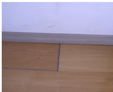
Figura 94 – Revestimento laminado solto.
