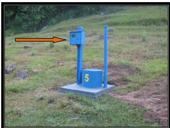
Figura 21: Instalação do medidor de pressão.
