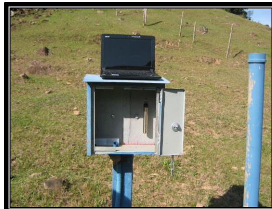
Figura 22: Instalação do medidor de pressão.
