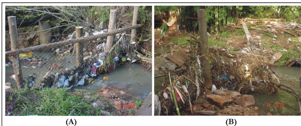
FIGURA 56 - Fotos das redes coletoras com resíduos sólidos nas Bacias Hidrográficas Alto da Colina (A) e Cancela (B)
