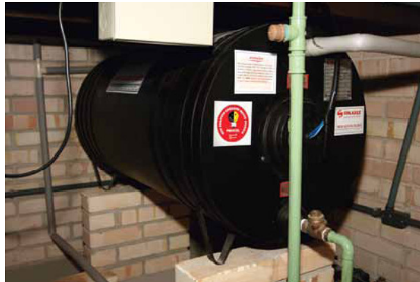
Figura 2.21 – Reservatório térmico usado na Casa Eficiente.
