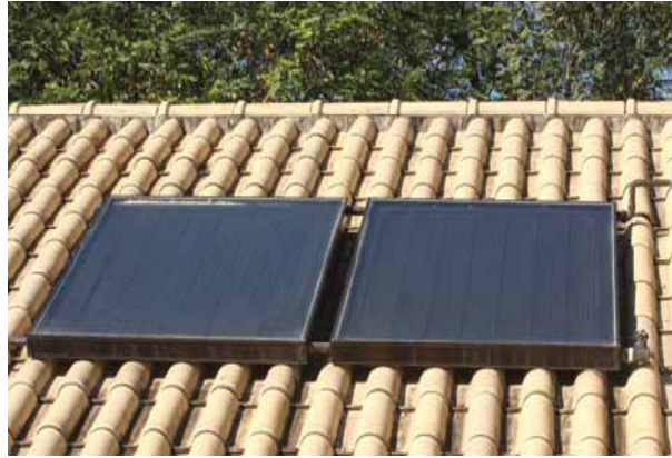
Figura 2.20 – Detalhe das placas coletoras sobre o telhado na Casa Eficiente.
