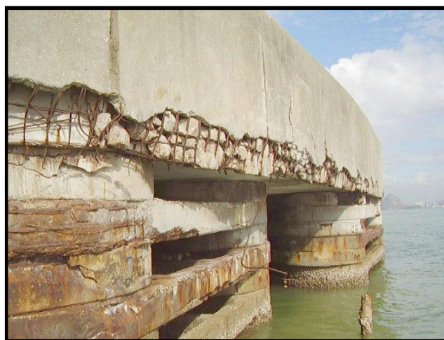
Figura 2.2 – Estrutura localizada na linha da maré severamente deteriorada Fonte: Aguiar (2006).
