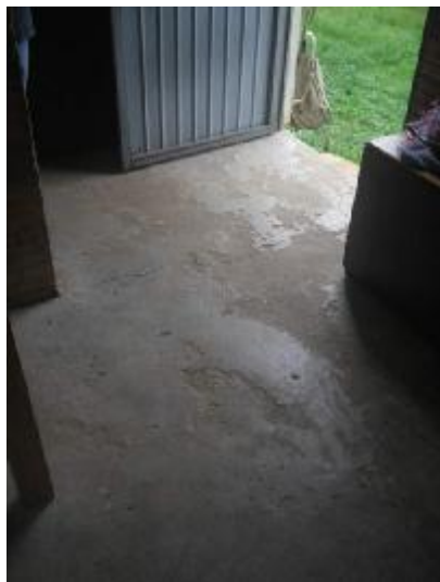
Figura 5.68 – Desgaste do piso, Bairro Élbio Vargas
