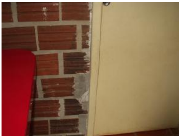
Figura 5.74 – Má qualidade da mão de obra no assentamento da porta, Bairro Élbio Vargas
