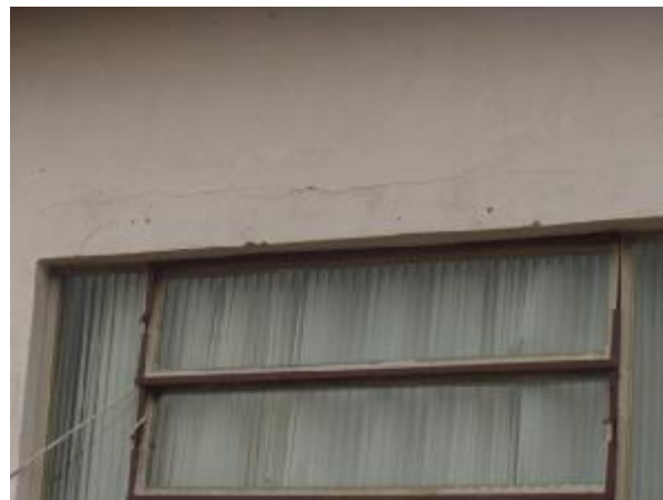
Figura 5.79 – Rachadura acima da janela, Bairro Élbio Vargas
