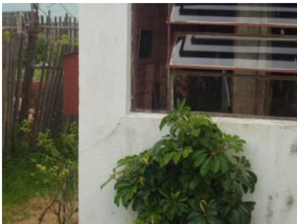
Figura 5.78 – Rachadura no canto da janela, em direção ao canto da casa, Bairro Élbio Vargas
