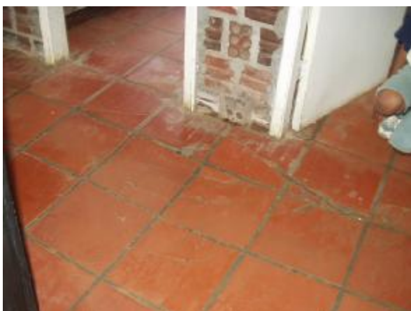
Figura 5.66 – Rachaduras no piso, Bairro Élbio Vargas
