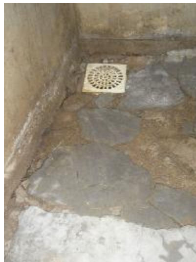
Figura 5.69 – Rachaduras no piso, Bairro Élbio Vargas
