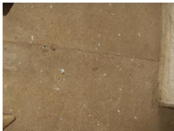
Figura 5.67 – Rachaduras no piso, Bairro Pró-Morar
