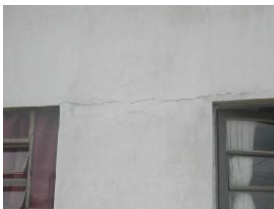
Figura 5.80 – Rachadura entre a janela e a porta, Bairro Élbio Vargas
