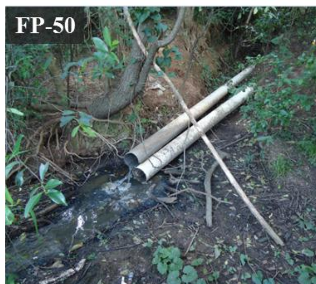
Figura 16 - Tubulações da fonte pontual FP-50.
